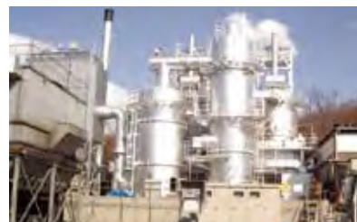
産業廃棄物焼却装置設備
